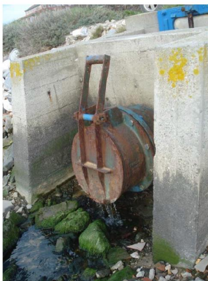
Figura 25. Válvula de descarga no Canal de Mira
