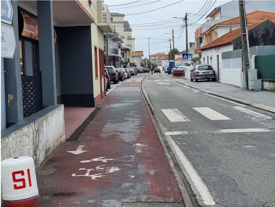
Fig. 71 Degradação do pavimento da pista ciclável na Rua Dom Manuel Trindade Salgueiro
