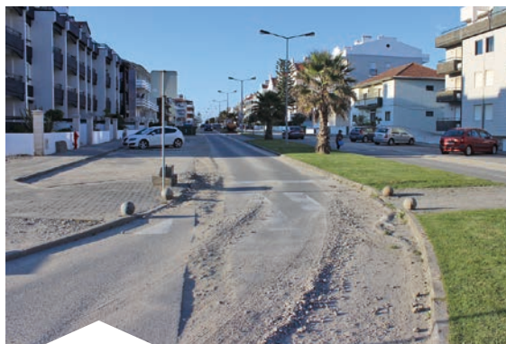
Novos Coletores de abastecimento de água, Costa Nova e Barra (CMI/AdRA)
