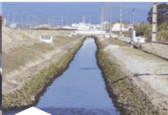
Vala Pluvial do Esteiro Oudinot (AdRA/CMI)
