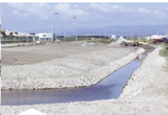
Vala Pluvial do Esteiro Oudinot (AdRA/CMI)
